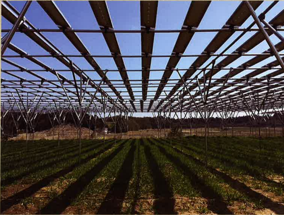
写真は千葉県匝瑳市のソーラーシェアリング発電所。 このような市民が作った再生可能エネルギー発電所の電気を集めてお届けします。
